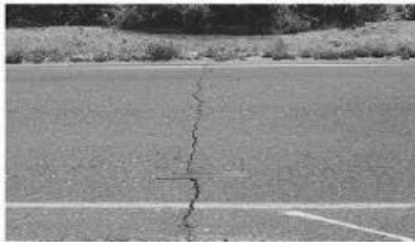
Gambar 3.13 Retak Melintang ( Transverse Cracks )
