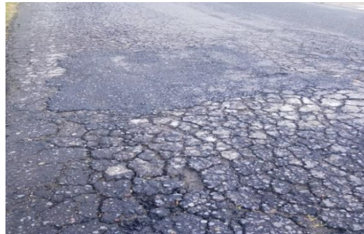
Gambar 3.15 Retak Kulit Buaya ( Alligator Cracks ) Sumber : Bina Marga No.03/MN/B/1983
