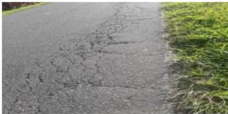
Gambar 3.12 Retak Memanjang ( Longitudinal Cracks ) Sumber : Bina Marga No.03/MN/B/1983
