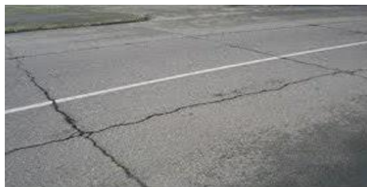
Gambar 3.14 Retak reflektif sambungan ( joint reflection cracks )
