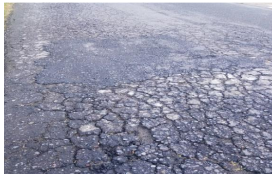
Gambar 3.15 Retak Kulit Buaya ( Alligator Cracks ) Sumber : Bina
