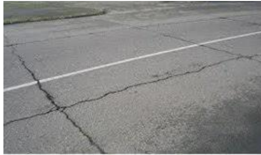
Gambar 3.14 Retak reflektif sambungan ( joint reflection cracks )
