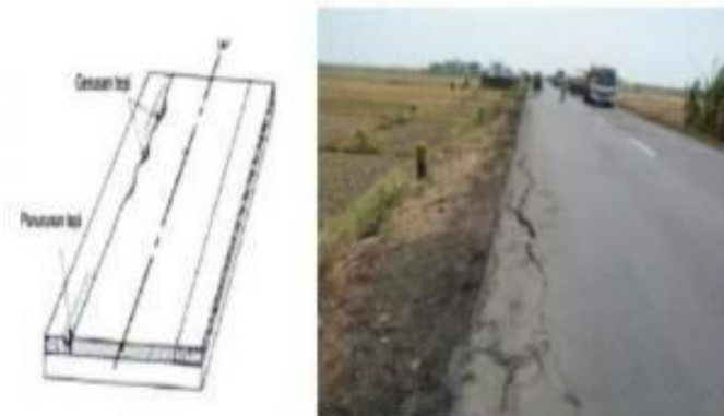
Gambar 3.18 Retak Samping Jalan ( Edge Cracking )
