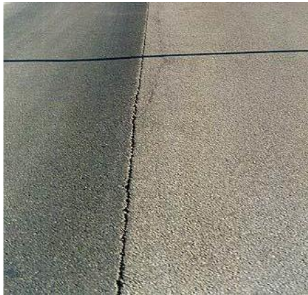
Gambar 3.8 Retak Sambungan Pelebaran Jalan
