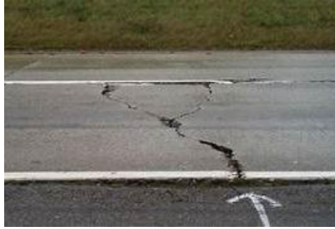
Gambar 3.6 Retak Sambungan Bahu
