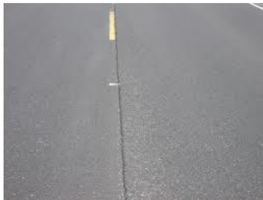
Gambar 3.7 Retak Sambungan Jalan
