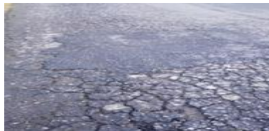
Gambar 3. 16 Retak Kulit Buaya ( Alligator Cracks )
