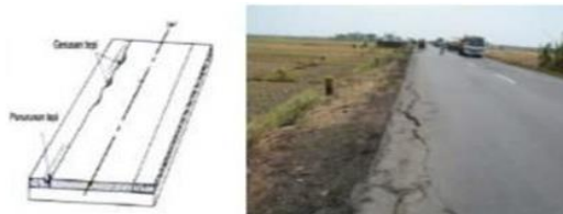
Gambar 3. 19 Retak Samping Jalan ( Edge Cracking ) (Sumber : Bina Marga 1983)
