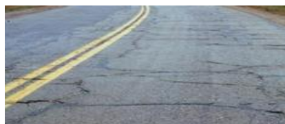
Gambar 3. 17 Retak Blok ( Block cracks )
