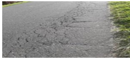
Gambar 3. 13 Retak Memanjang ( Longitudinal Cracks )
