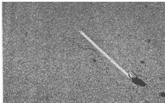
Gambar 3. 13 Kerusakan Pelapukan dan Butiran lepas
