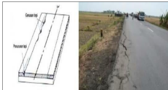
Gambar 3. 8. Retak Samping Jalan ( Edge Cracking )
