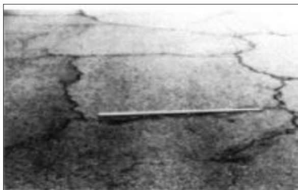
Gambar 3. 4. Retak Kotak-kotak ( Block Cracking )
