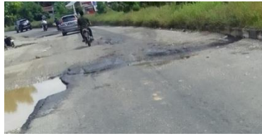
Gambar 1. 1 Kerusakan bahu jalan pada lokasi penelitian
